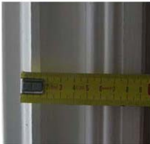
Kuva 5. Talo 1 kuistin ikkunan vuorilista (liite 17/5)
