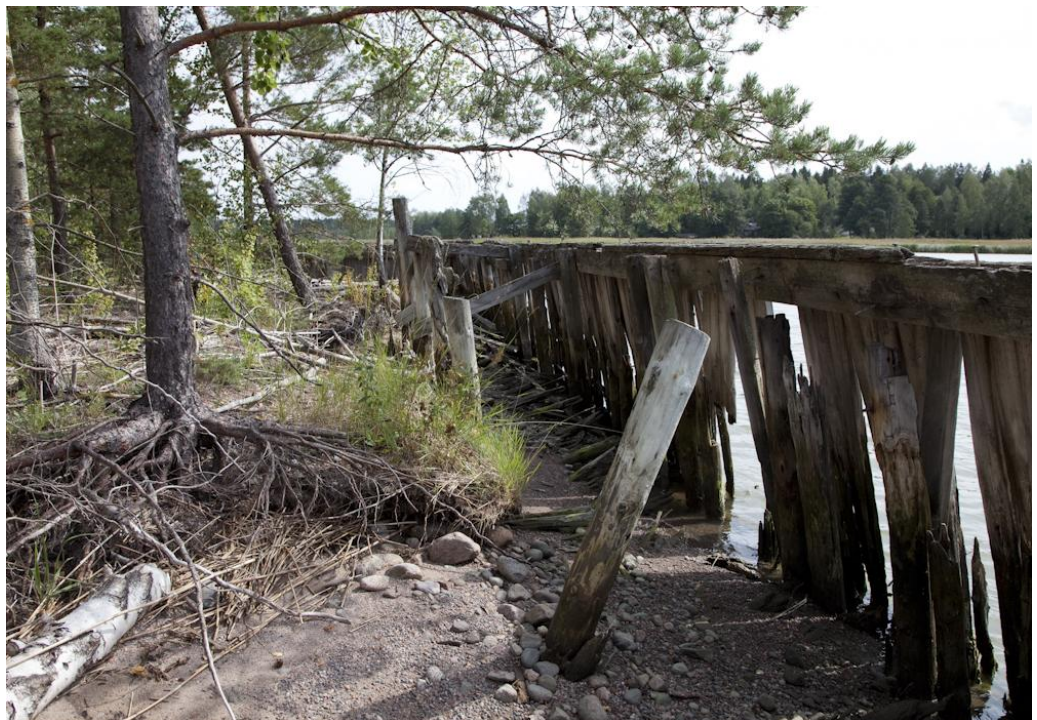
Kuva 25. Furuholmenin etelärannan eroosiosuojausta. Valokuva © Markku Nironen.
