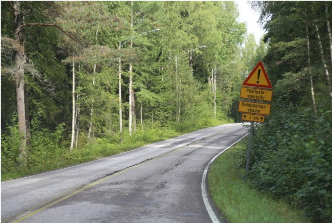
Kuva 5. Voolahdentien (mt 11859) päällyste on vaurioitunut ja pientareet olemattomat. Kaarteisuuden ja kasvillisuuden aiheuttamat huonot näkemät lisäävät onnettomuusriskiä.
