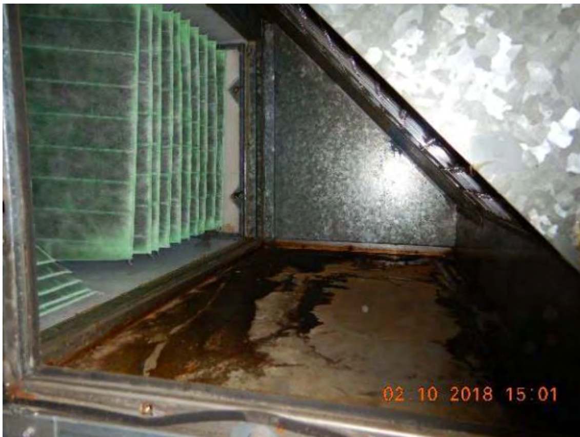
Kuva 47. E-osan ilmanvaihtokone sisältä.
