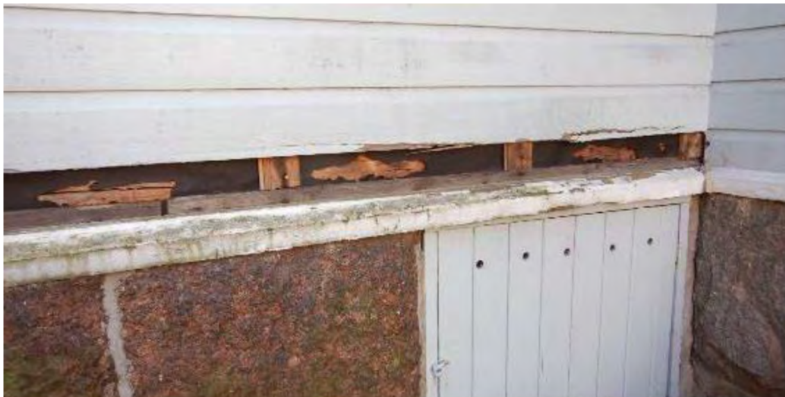
Kuva 25. Ulkoseinän julkisivulaudoituksen kunto oli paikoitellen heikko.
