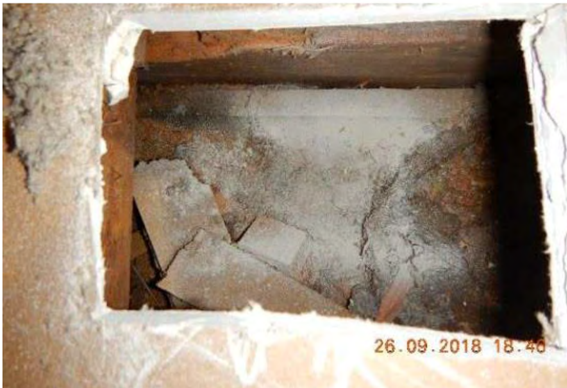
Kuva 11. Avauksen A16 kipsilevyn alla tyhjättila, jossa rakennusjätettä.
