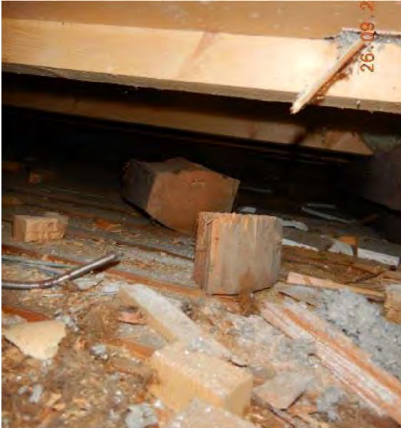
Kuva 12. Avauksen A16 kipsilevyn alla rakennusjätettä. Kipsilevyn alapinnassa valkoista kasvustoa.
