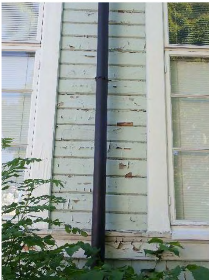
Kuva 23. Julkisivupinnoitteen vauriojälkiä sadevesisyöksyn takana.
