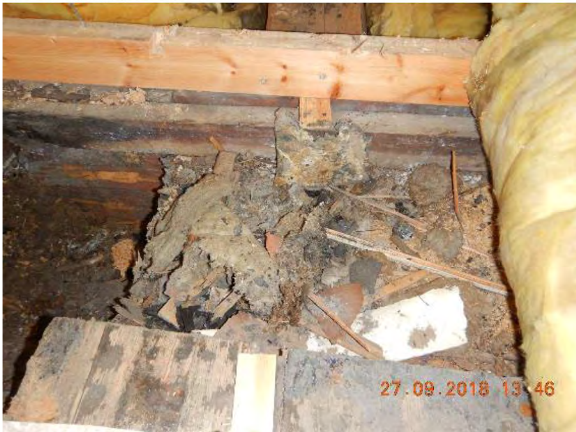
Kuva 13. Alapohja-avaus A01. Laajennoksen puolella eristetilassa rakennusjätettä.
