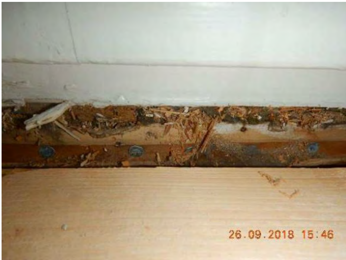
Kuva 26. Ikkuna-avaus I15 tilassa 2078. Tummentunut tilkevilla ja ikkunan alapuolella pahvi.
