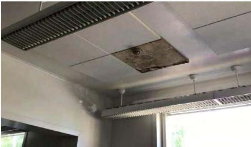
Kuva 34. Huoneiden katoissa akustiikkalevyjä. Kuvassa yksittäinen vaurioitunut akustiikka-levy.
