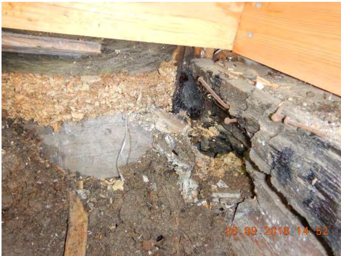
Kuva 14. Alapohja-avaus A01. Entisen ulkoseinän kohdalla kulkevassa hirressä palovaurio.
