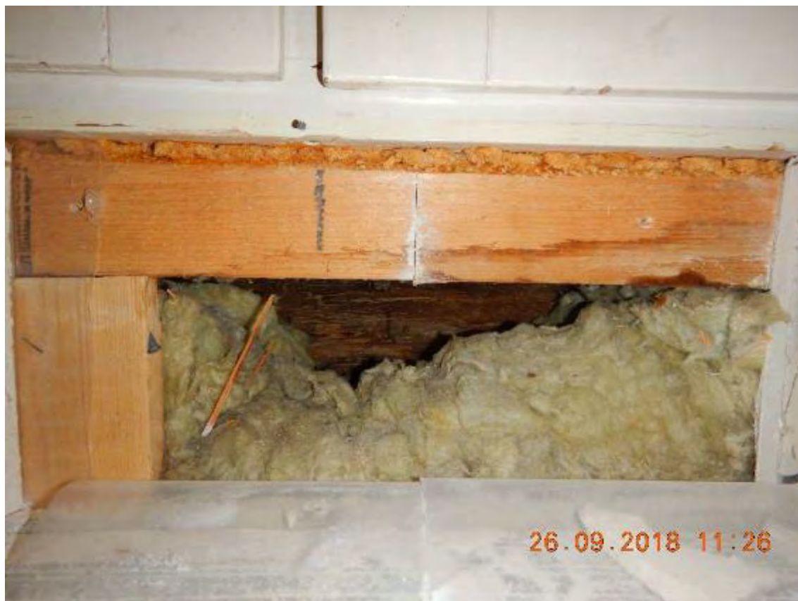
Kuva 43. Ulkoseinäavaus U31. Mineraalivillan takana hirsi, joka näyttää laholta.
