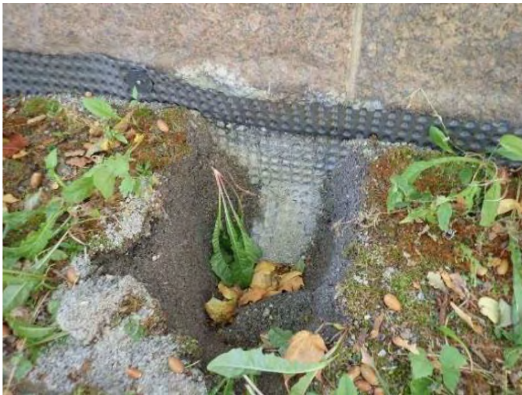
Kuva 11. Sokkeliä vasten patolevy. Patolevyn yläreuna ei ole kiinnitetty tiiviisti.
