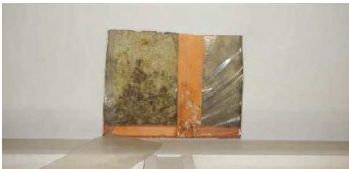
Kuva 49. Yläpohja-avaus Y03. Villaeristeessä tummentumaa.
