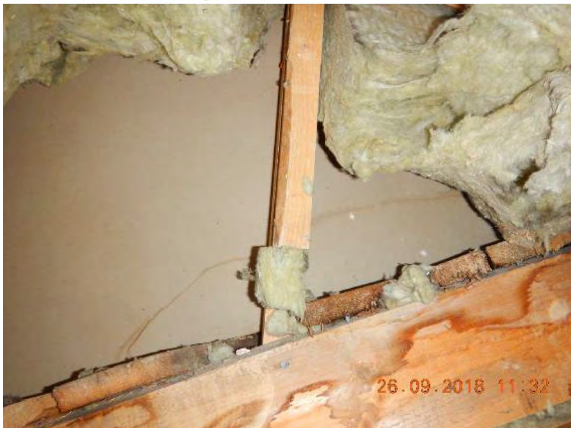
Kuva 58. Mineraalivillan takana olevassa kipsilevyssä kosteusjälkiä.
