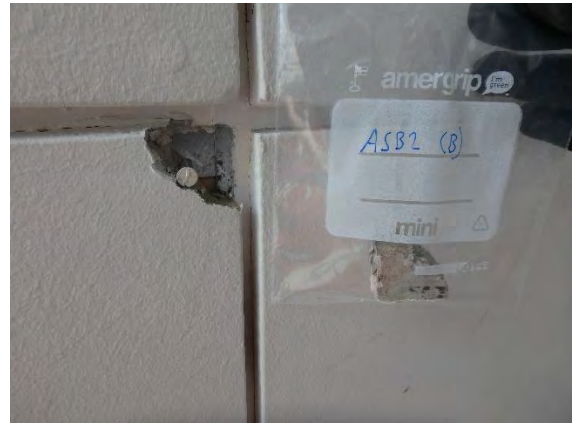
Kuva 25. Kokoamanäyte porrashuoneen lujalevystä (ASB2) sisältää asbestia.
