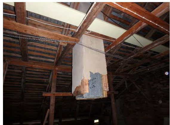
Kuva 41. Näyte ullakolla olevan vanhan hormin lujalevystä (ASB14) sisältää asbestia.
