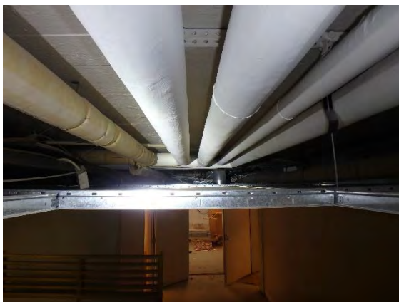
Kuva 20. Asbestipitoisia putkieristeitä ensimmäisen kerroksen alaslasketun katon sisällä.
