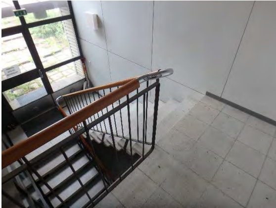
Kuva 30. Porrashuoneen seinissä asbestipitoista lujalevyä.
