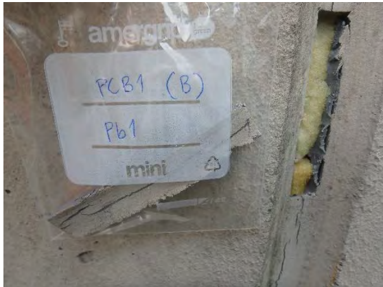
Kuva 62. Näyte julkisivuelementin saumamassasta (Pb1).
