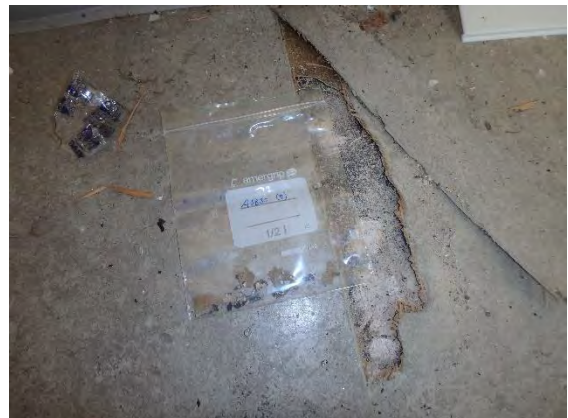
Kuva 46. Kokoamanäyte lattian mustasta liimasta (ASB30) sisältää asbestia.
