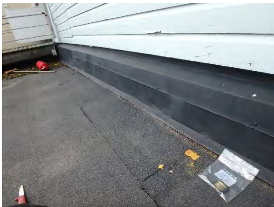
Kuva 93. Näyte kattoterassilta vesikaton kermistä (PAH6).
