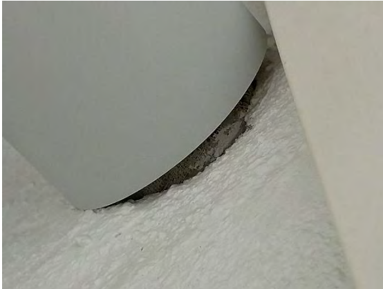
Kuva 22. Asbestipitoinen putkieriste jätetty seinän sisälle tilojen 1031 ja 1025 välissä, vaikka seinän molemmiin puolin eriste on muuten purettu.
