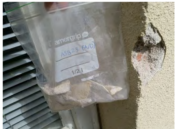
Kuva 15. Kokoamanäyte julkisivurappauksesta (ASB23) sisältää asbestia.
