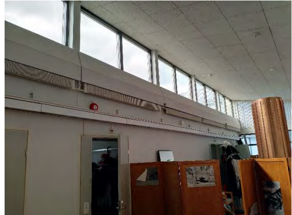
Kuva 31. Asbestipitoista lujalevyä on käytetty myös ikkunoiden ja patterien välissä olevassa levytyksessä.
