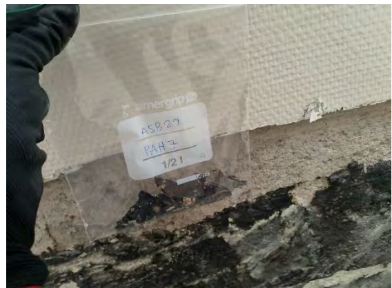
Kuva 94. Kokoamanäyte alapohjan bitumisivelystä (PAH7).
