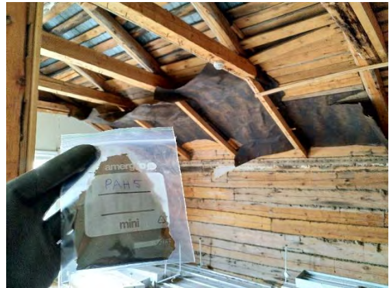
Kuva 98. Näyte vesikaton tervapaperista (PAH5). Tervapaperia havaittiin vain ullakon toisessa päädyssä kuvassa näkyvä kaistale.
