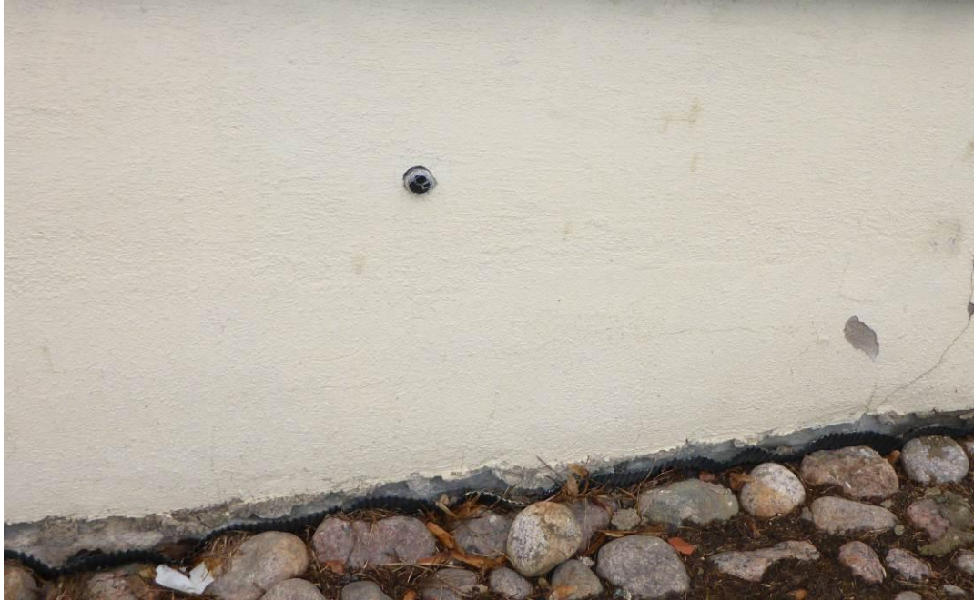
Kuva 9. Patolevyn yläreuna on kiinnittämättä ja tiivistämättä ja patolevy aaltoilee.
