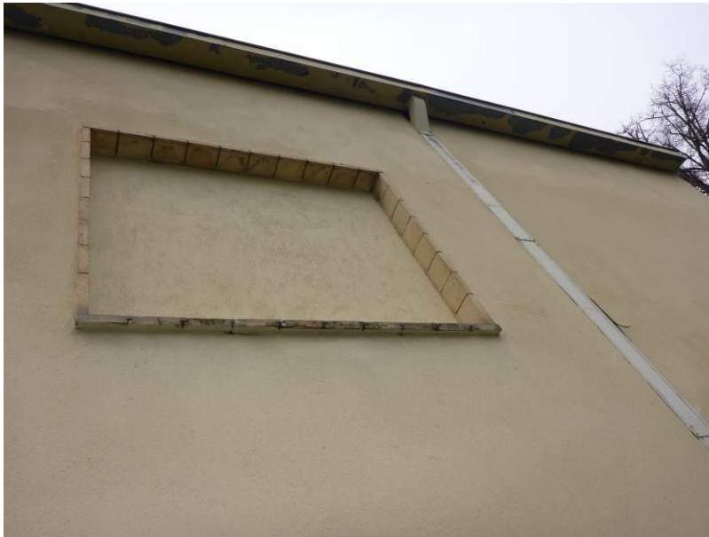
Kuva 5. D-osan suljettu ikkuna-aukko, jonka keraamisella laatalla toteutetut reunukset vastaavat muita toisen kerroksen ikkunoita. Vieressä julkisivupintaan upotettu syöksytorvi.
