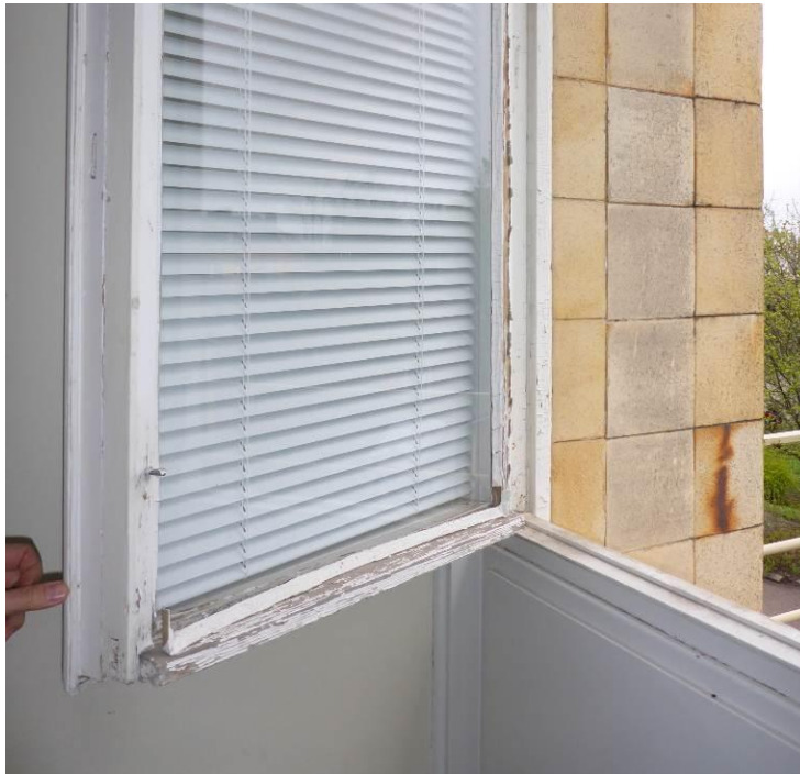
Kuva 8. Ikkunan ulkopuite D-osassa. Puitteet ovat vähintään kunnostuksen tarpeessa.
