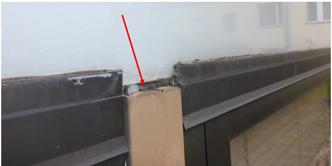
Kuva 17. Julkisivupinnan saumauksia. Tämä sauma on uusimisen tarpeessa.
