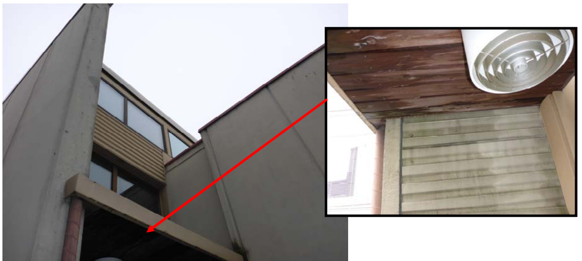
Kuva 20. Sisäänkäyntikatokas kastuu sateella katon alapintaa myöten. Kastuminen viittaa katoksen tulvimiseen yli reunan tai katoksen vesikourun vuotamiseen.
