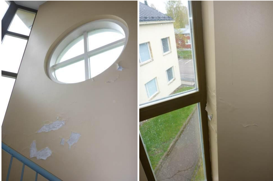
Kuvat 12 ja 13. Aulatilaan liittyvän porraskäytävän kosteusvaurioita. Vasemman puoleisessa kuvassa esiintyvien vaurioiden syy saattaa olla mahdotonta poistaa täysin, jolloin tilannetta tulee hallita sisäpuolisin materiaaliteknisin ratkaisuin.
