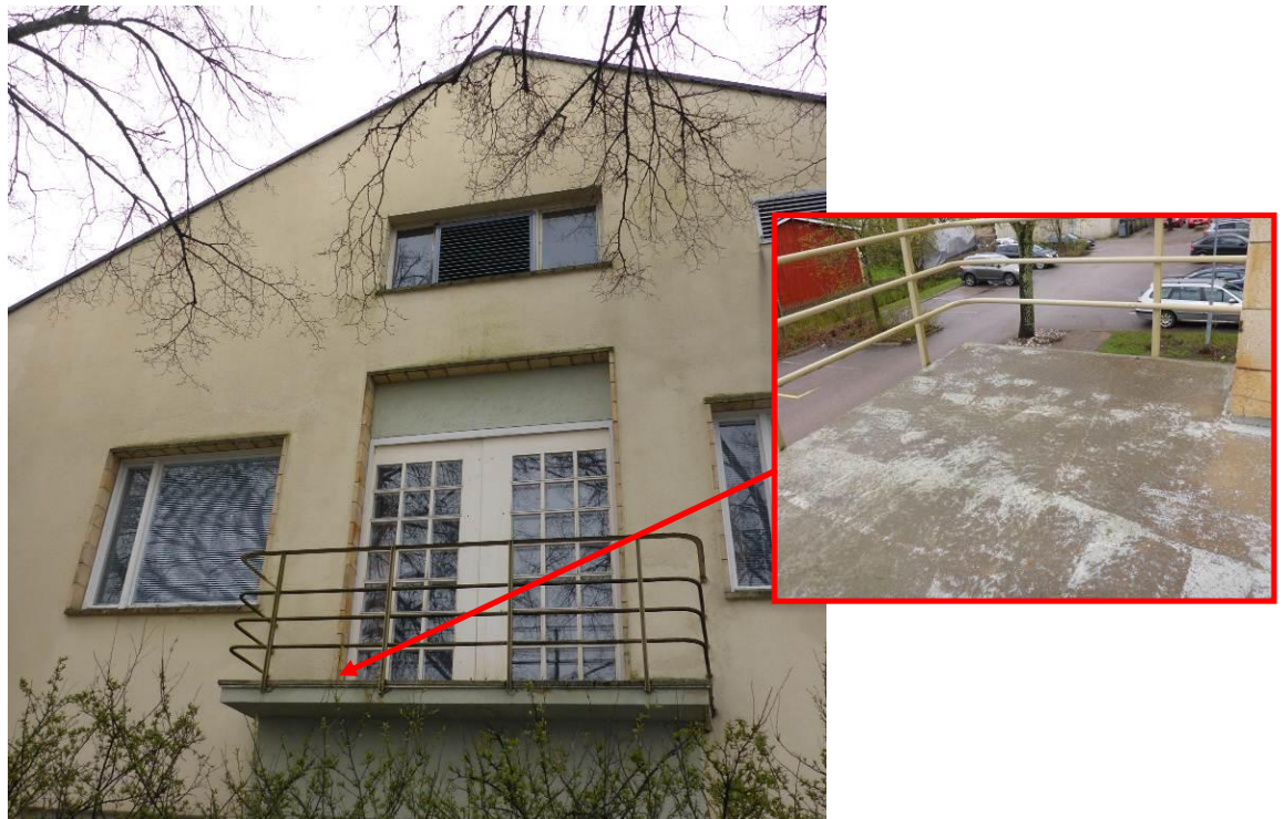
Kuva 7. D-osan päädyn parveke. Pikkukuvassa on parvekelaatan pintaa, jonka maalipinnoite on kulunut pois.
