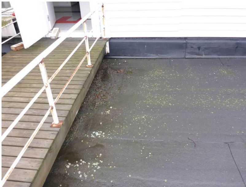
Kuva 14. Välioson päällä sijaitsevan kermikaton kallistukset ovat puutteellisia.
