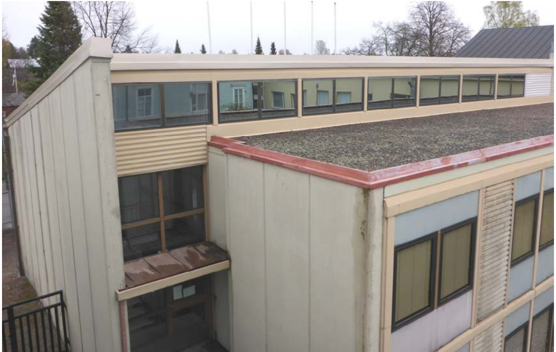
Kuva 16. B-siipi sisäpihan puolelta. Kuvassa näkyy betonielementtijuoksisivua päädyissä sekä kevyitä ulkoseinäelementtejä pitkällä sivulla.
