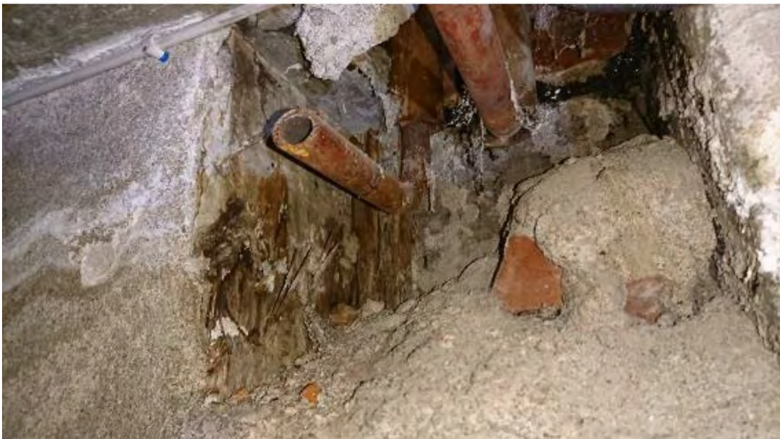
Kuva 32. Katkaistuja putkilinjoja putkikanaalissa.
