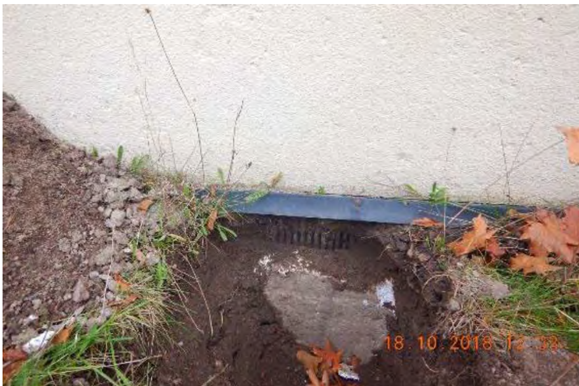
Kuva 17. D-osalla patolevy ja EPS-eriste. Kaivauskohdasta havaittiin vierustäyttöjen olevan kapillaarisesti kosteutta nostavaa.
