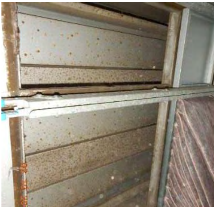
Kuva 66. Suodattimien takana oleva seinä on heikossa kunnossa
