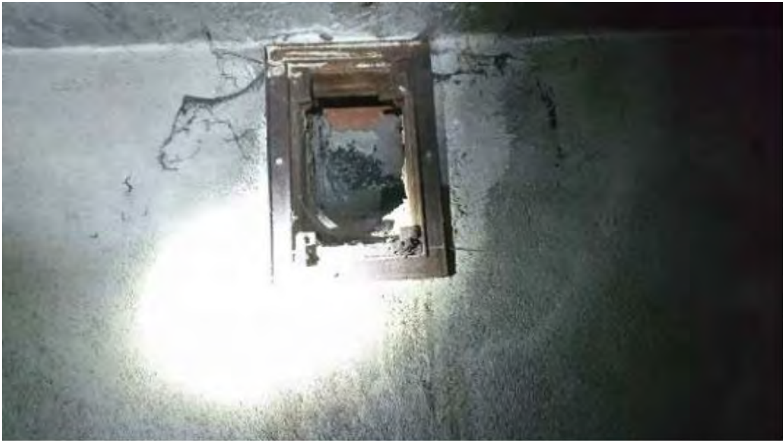
Kuva 31. Vanha lämpöilmakanava putkikanaalissa.
