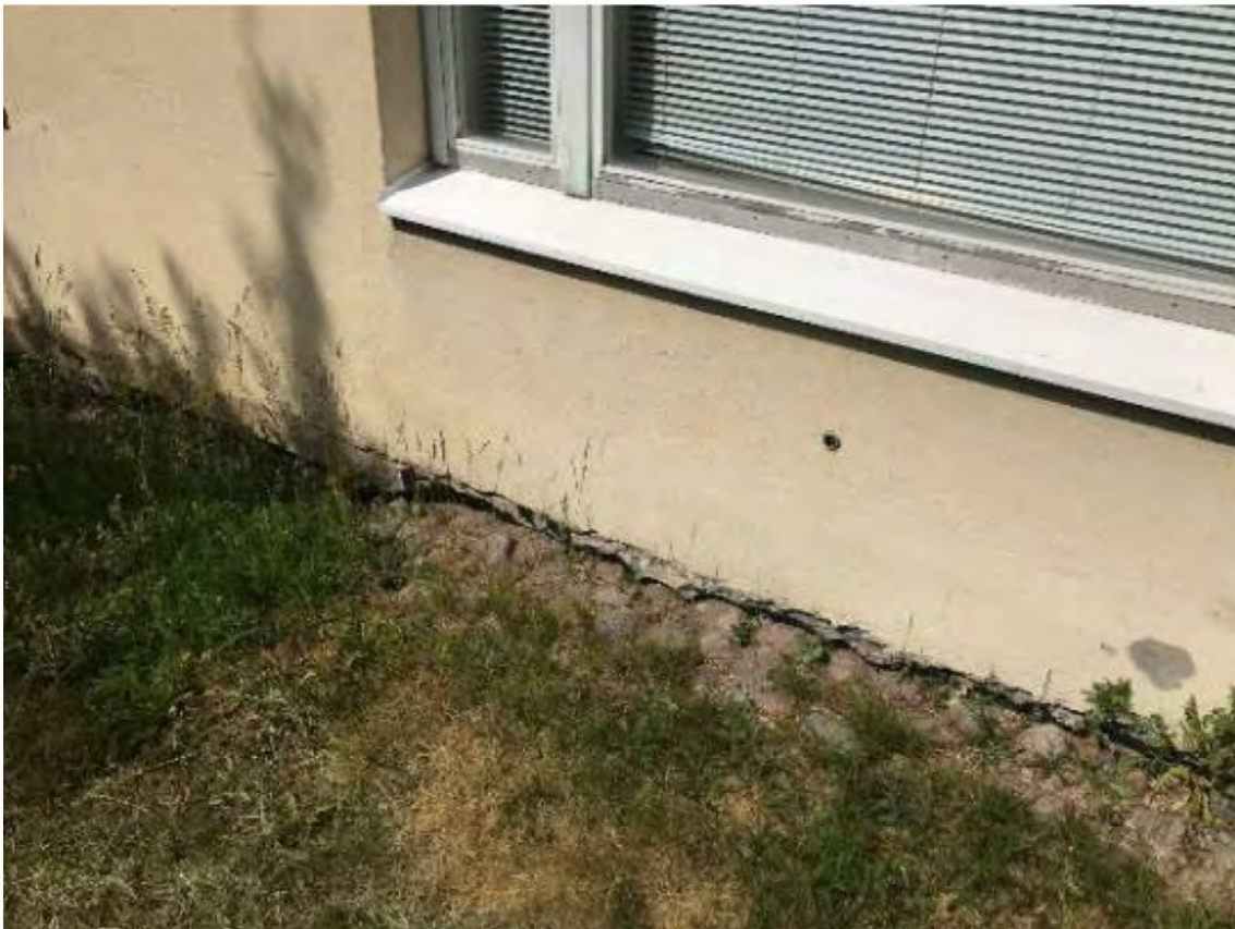
Kuva 16. A-osan vierustalla kulkee patolevy, jonka yläreunaa ei ole tiivistetty seinään.
