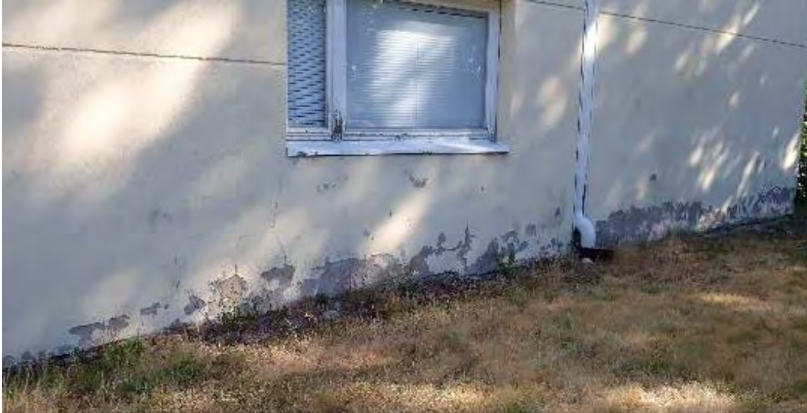
Kuva 15. Sokkelin julkisivupinnoite on halkeillut ja irronnut.
