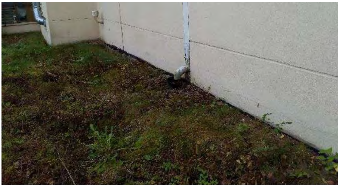
Kuva 4. Sisäpihan puoleisella seinustalla sadevedet laskevat kohti rakennuksen seinustaa.
