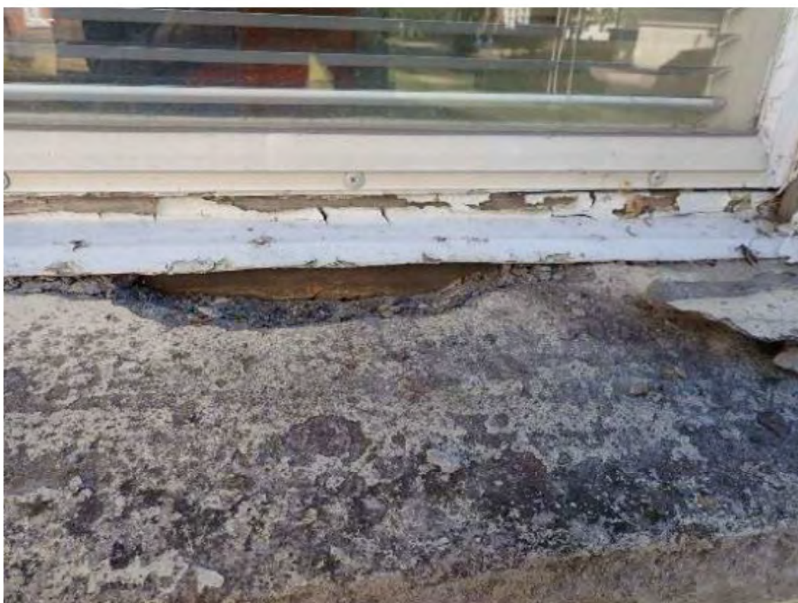
Kuva 56. Paikoitellen betonisia ikkunalautoja, joissa vaurioita.
