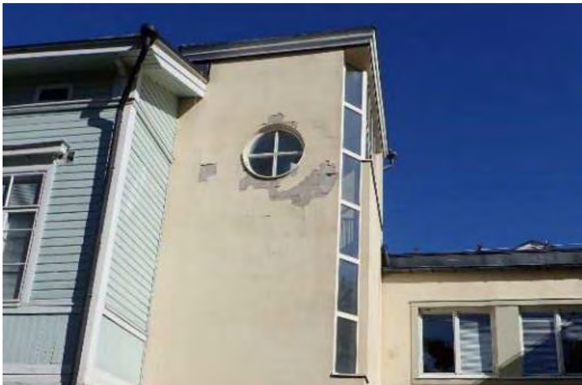
Kuva 52. Ulkoseinärappaukset rapaisseet osittain pois.
