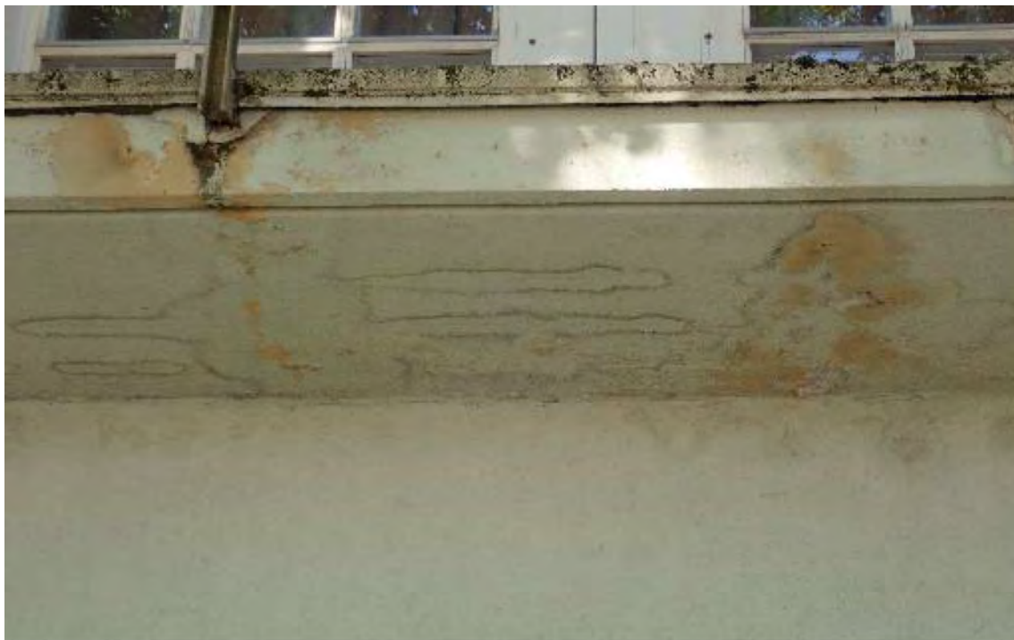
Kuva 50. A-osan päädyn parvekkeen alapuolella on kosteusrasitukseen viittaavia jälkiä.
