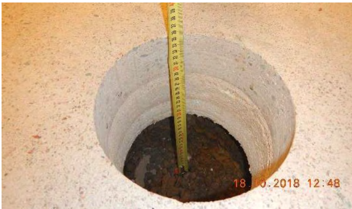
Kuva 23. Vanha alapohja-avaus A4. Maa-aines on painunut.
