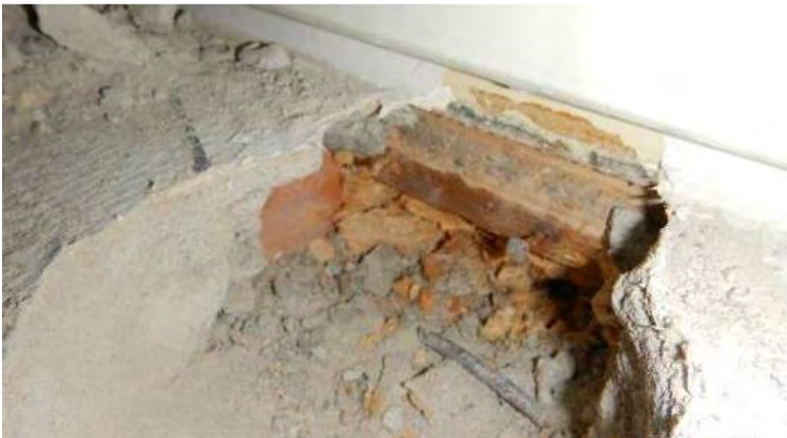
Kuva 54. Ikkuna-avaus I4 tilassa 1056. Apukarmi tummuneen näköinen, mutta puukolla ko- keillessa kova. Naulassa ruostetta, joka viittaa siihen, että rakenteeseen on päässyt kos- teutta.
