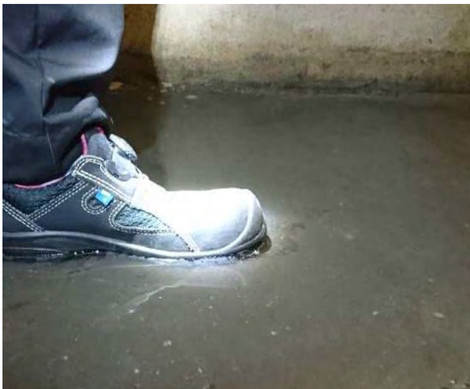
Kuva 33. Vettä putkikanaalin lattialla n. 10 mm.
