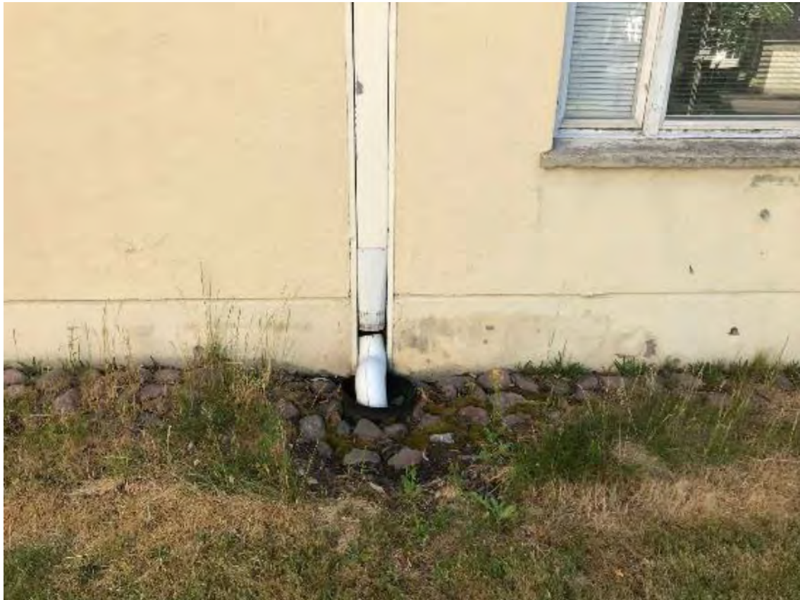
Kuva 63. Syöksytorvet on upotettu seinärakenteeseen. Suora osa ja mutka eivät ole kiinni toisissaan.
