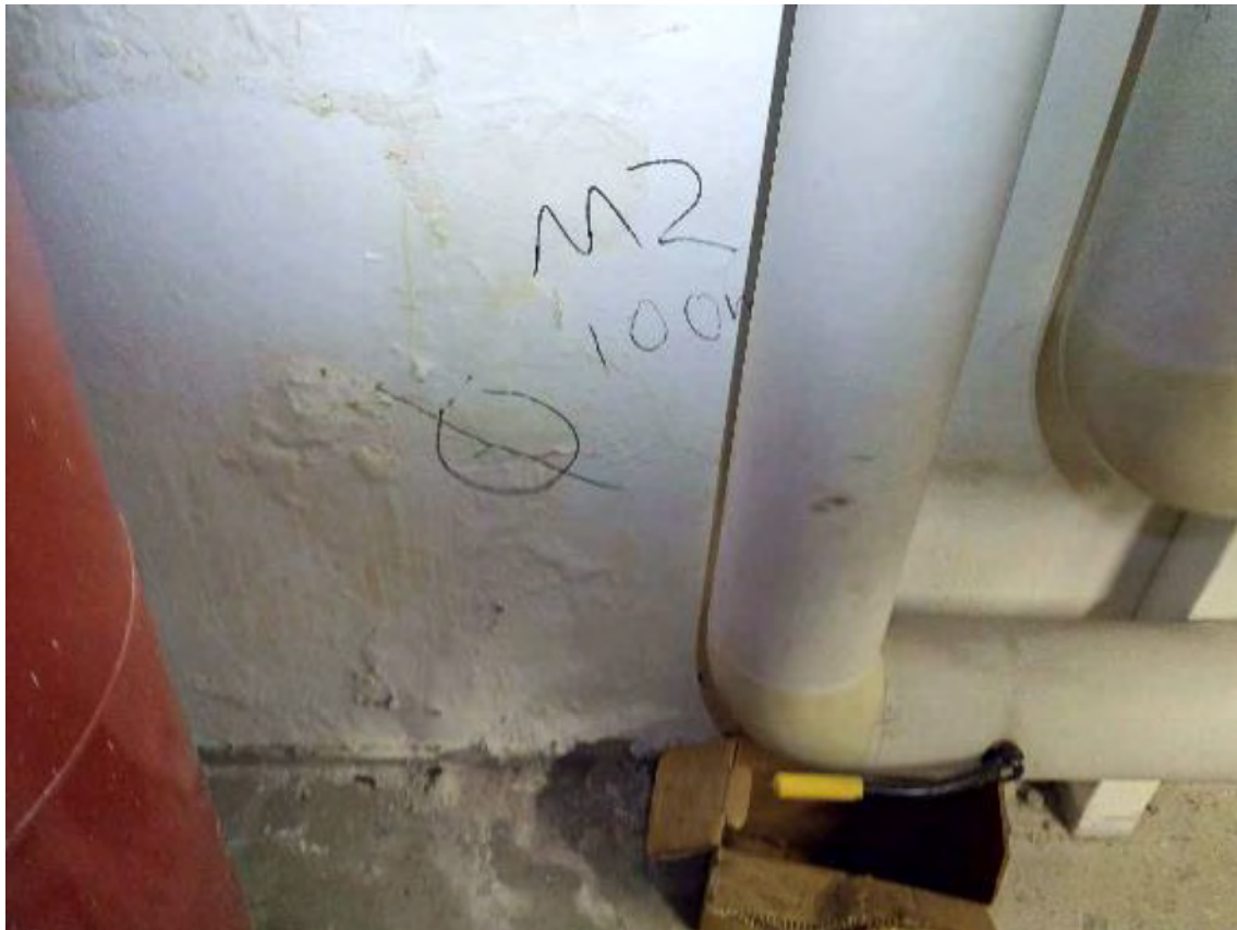
Kuva 9. Kellarin teknisen tilan seinällä havaittiin maalipinnan irtoilua kohonneen kosteuspi-toisuuden seurauksena.
