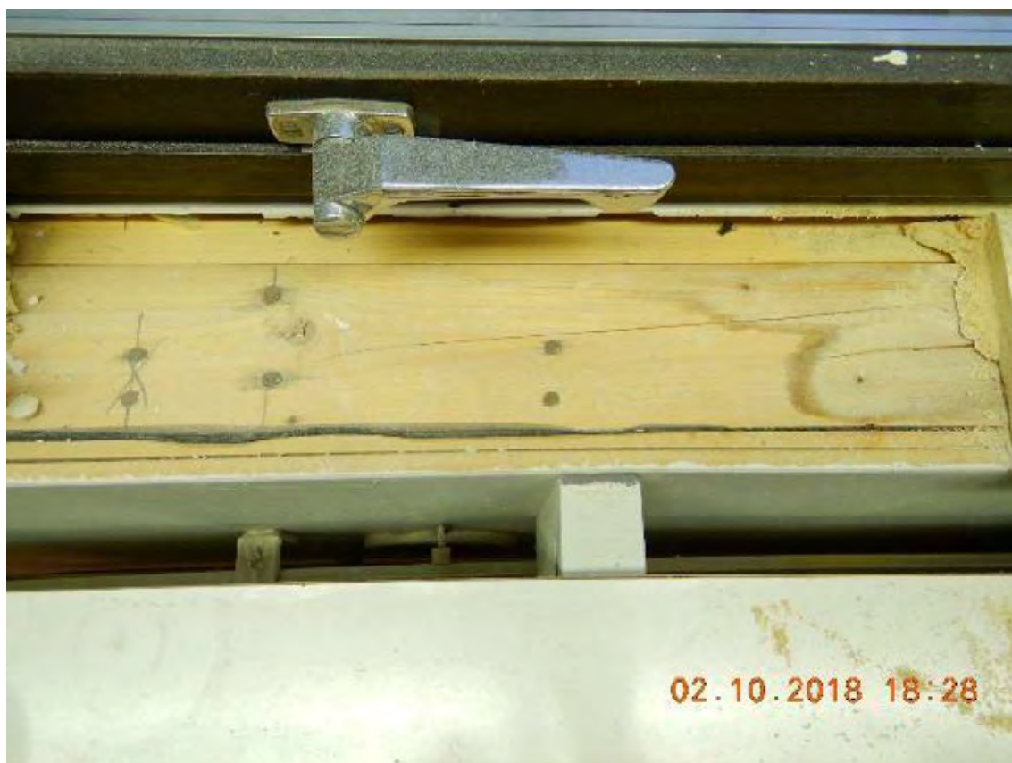
Kuva 36. Ruosteisia nautoja ja vesijälkiä avauksessa I11.
