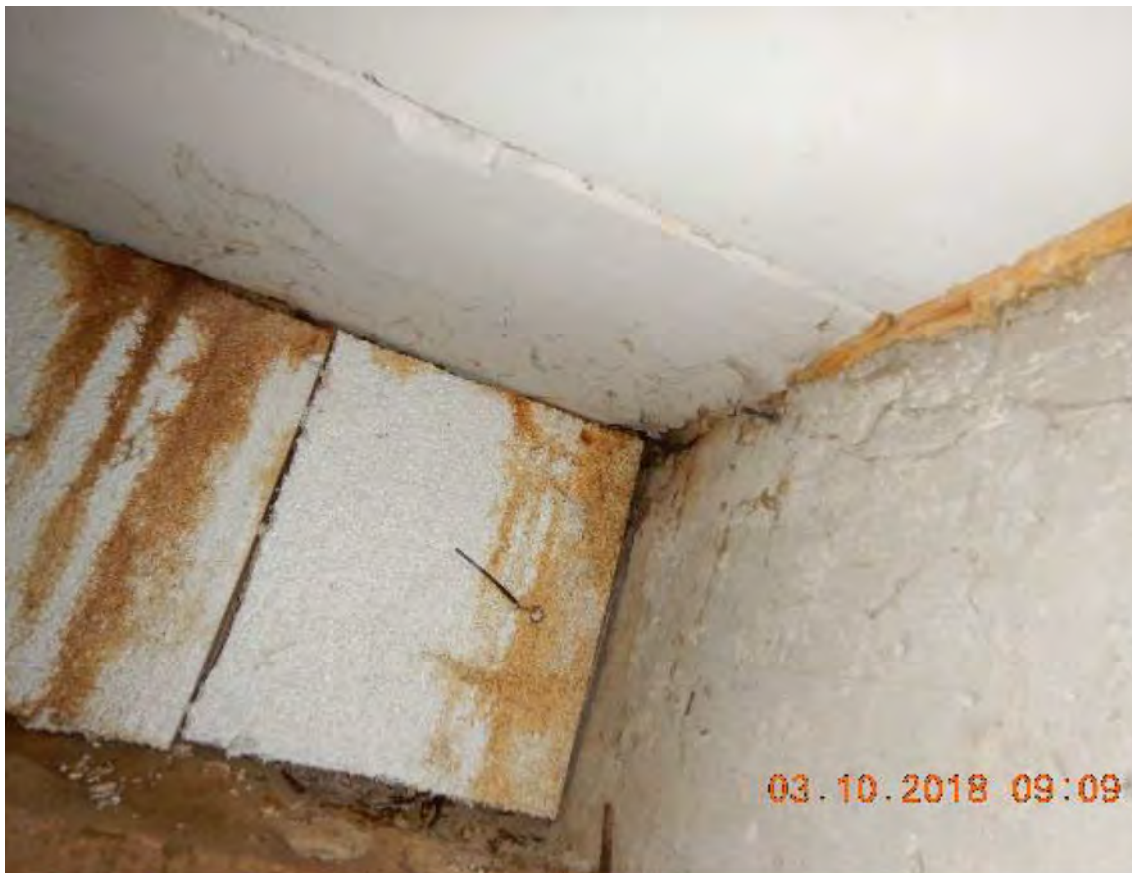
Kuva 17. Ryömintätilasta. Oikeassa yläkulmassa näkyvillä mineraalivilla kevytbetonilankun alta. Sokkelin kyljissä ja kevytbetonilankun pohjassa olevissa EPS-eristeissä jälkiä kosteusra- situksesta.
