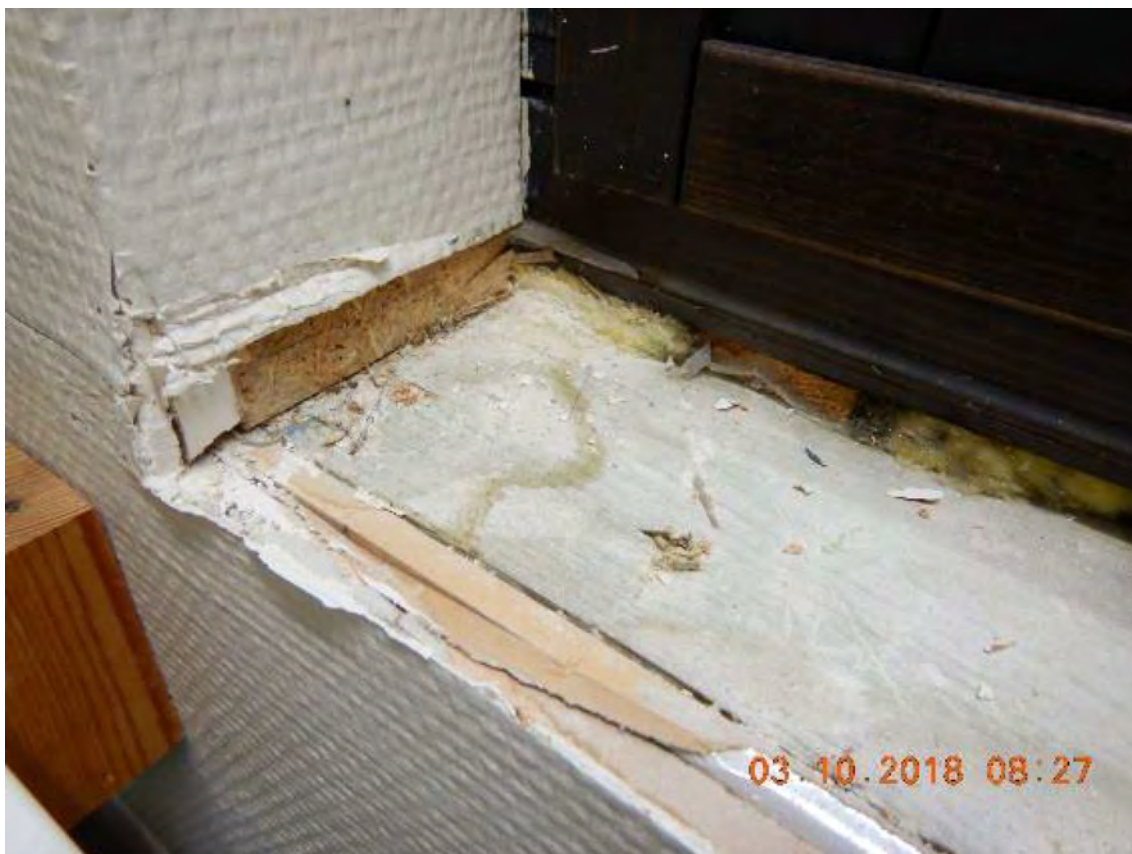
Kuva 34. Vesijälkiä avauksessa I10.
