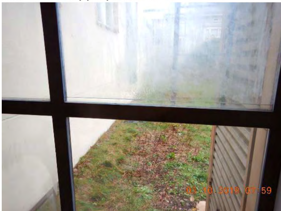
Kuva 37. Vettä porraskäytävän 1002 ikkunalasien välissä.
