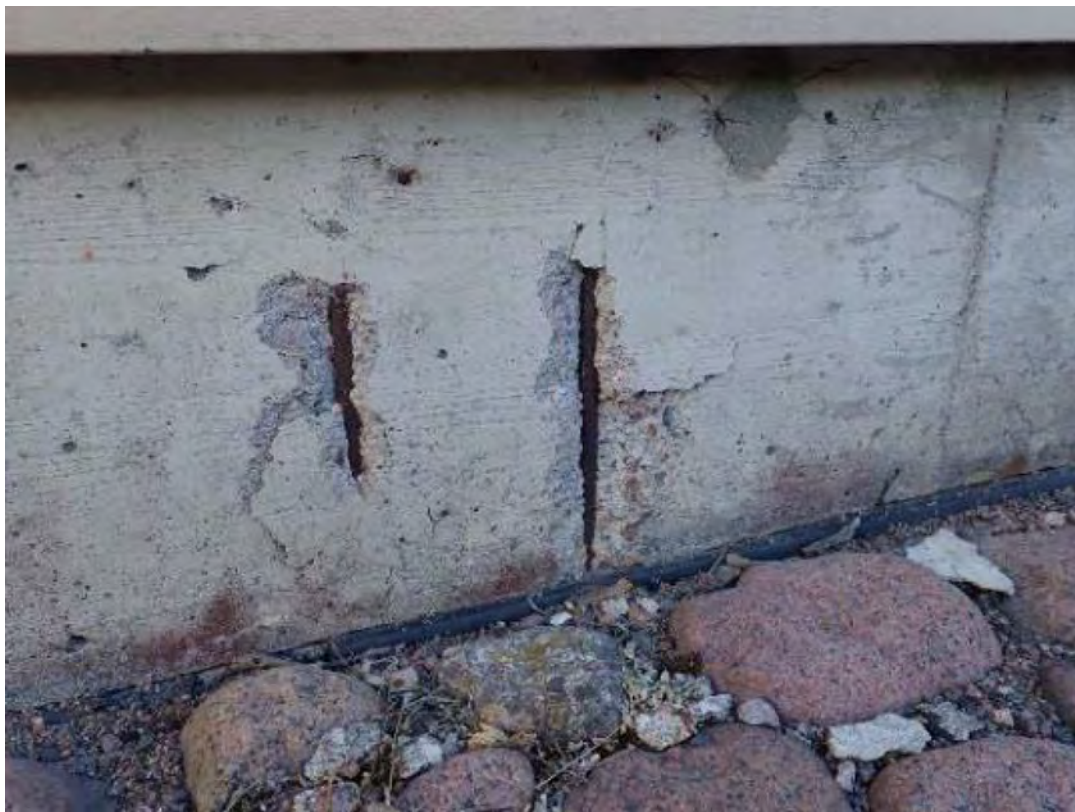
Kuva 9. Sokkelin Sk2 raudoitukset paikoin näkyvissä. Patolevy ei ole tiiviisti sokkelissa.
