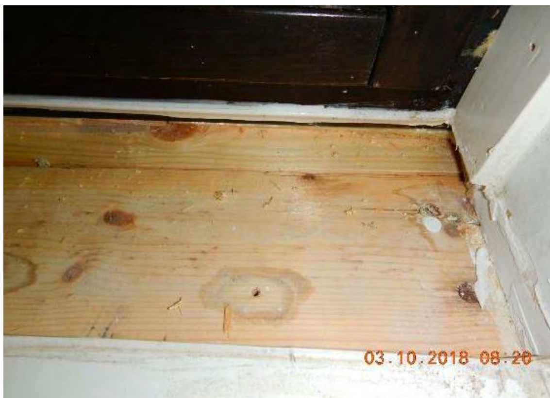
Kuva 33. Kosteusjälkiä avauksen I9 ikkunalaudassa.
