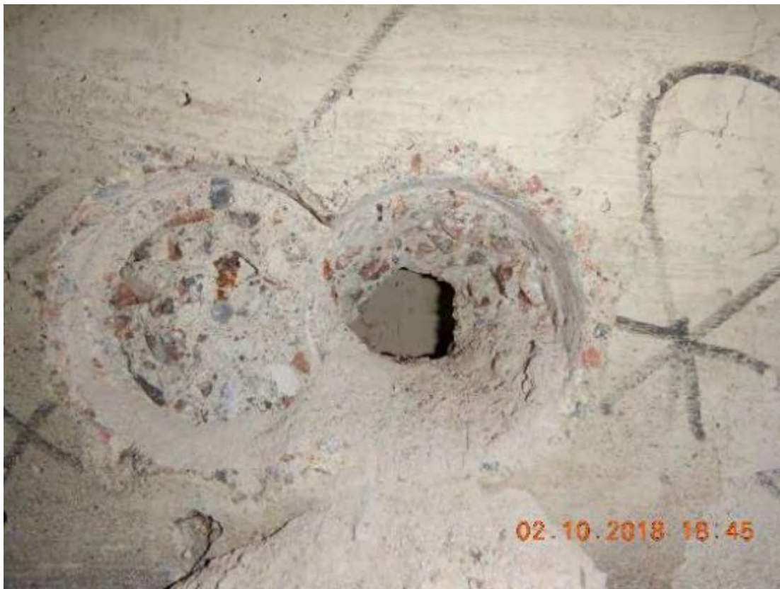
Kuva 10. Sokkeliavaus Sk2. Betonin takana ilmarako ja kovalevy.
