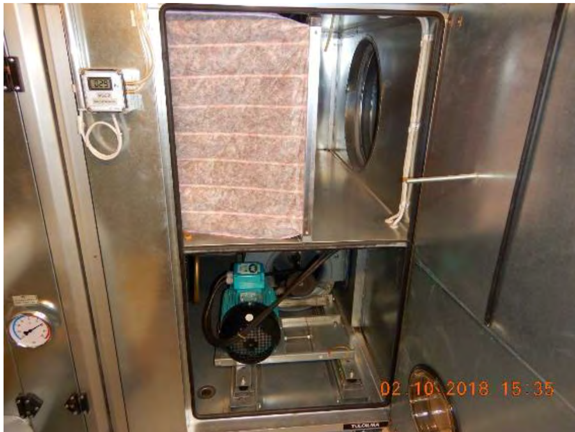
Kuva 44. Ilmanvaihtokone on aistinvaraisesti havainnoituna siisti sisältä.
