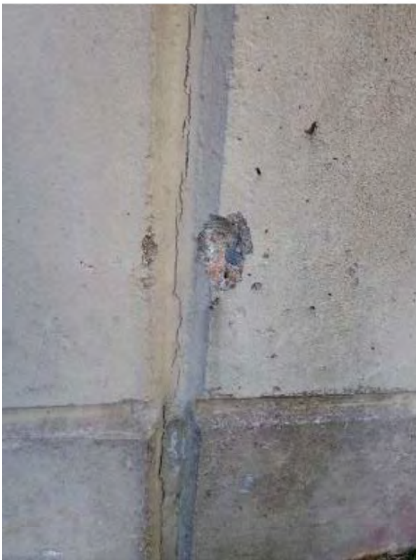
Kuva 29. Elementtisaumat ovat halkeilevat. Betonissa paikallisia vaurioita.
