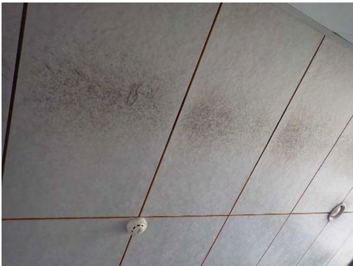
Kuva 43. Akustiikkalevyjä katossa. Reunat ovat käsittelemättömiä. Pinnassa tummentumaa.
