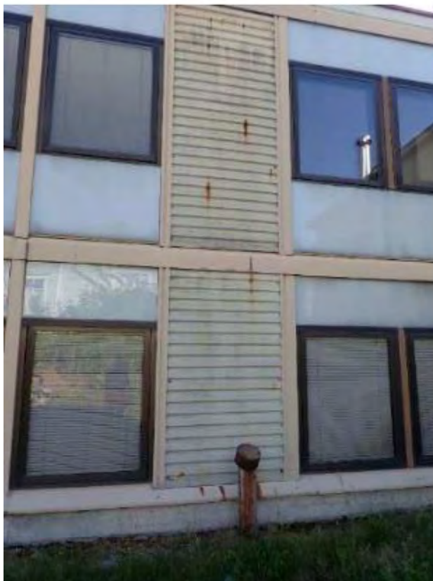
Kuva 25. Ulkoseinärakenteen ulkoverhoilut sisäpihan puolelta. Aaltopellissä ruostetta.
