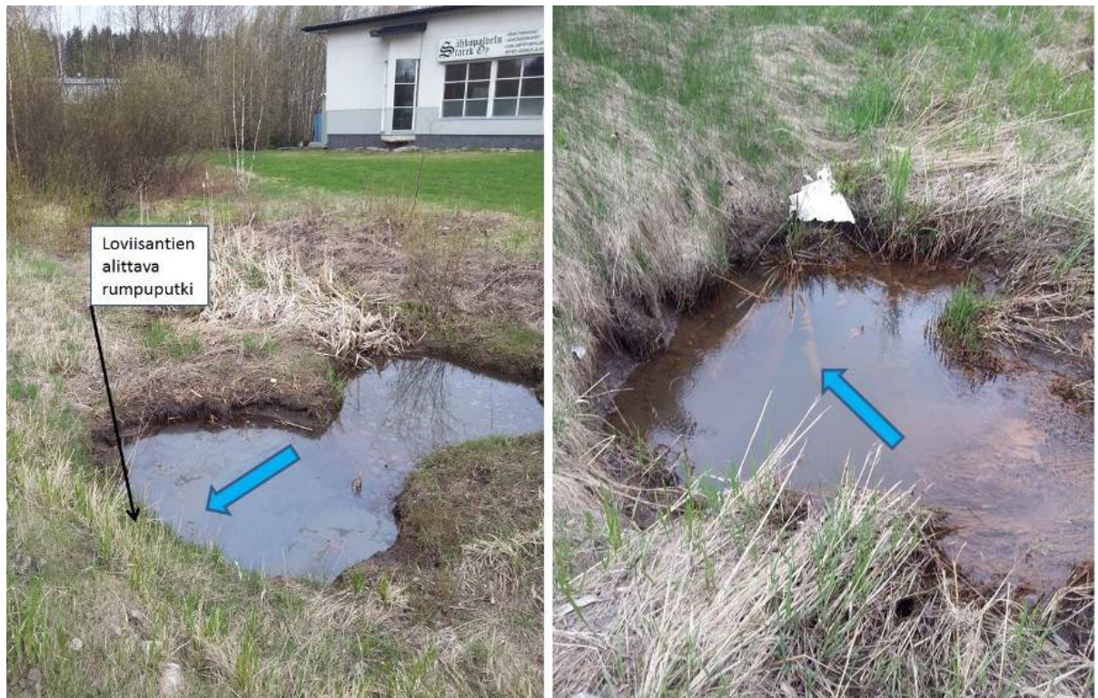
Kuva 2. Loviisiantien alittavaa umpuputkeä ei näkynyt maastokäynnin yhteydessä. Vesi seisoi lammikossa viitaten heikkoon välityskapasiteettiin.
