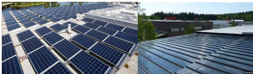
Kuva 5 Vasemmalla katolle asennetut aurinkopaneelit, oikealla kattopeltiin integroitu ohutkalvoaurinkopaneeli
