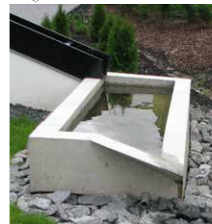
En konstruktionsmässig bassäng för insamling av dagvatten.
