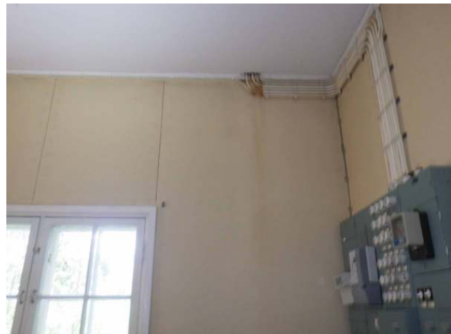
50. Kosteuden aiheuttamat jäljet muissa tiloissa
