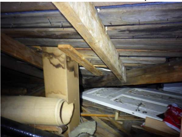
43. Vesikaton alusrakenteissa on kosteusjälkiä
