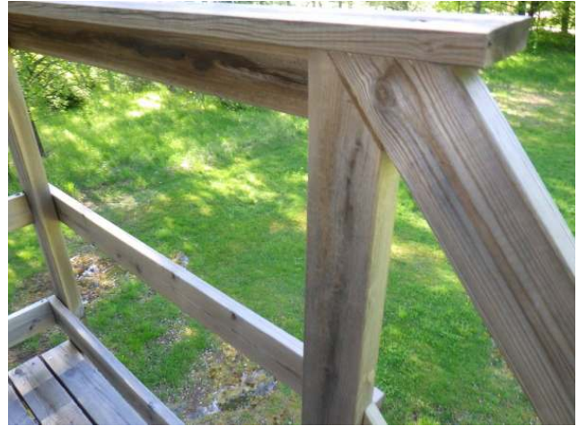
8. Ulkoportaiden kaiteet heiluvat ja niiden raot ovat suuret
