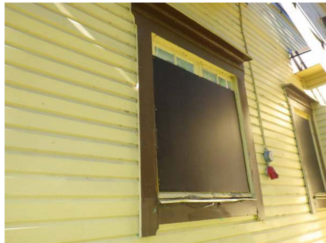
29. Osa ikkunoista on levytetty kohteessa tapahtuneen ilkeivallan vuoksi
