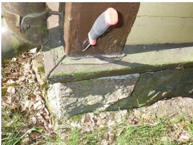
17. Seinän alaosassa on paikoin puuosissa vaurioitumista
