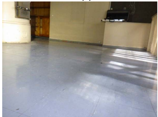
54. Mm. yläkerran aulassa on rakenteissa suoruuspoikkeamaa
