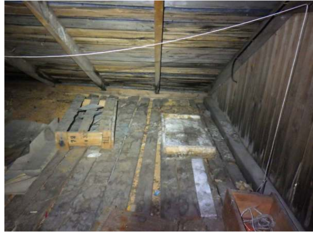
40. Vesikatteen alusrakenteissa ja eristeiden päällä on katteen kondensoitumiseen viittaavia merkkejä
