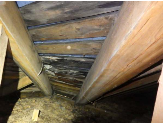
41. Vesikaton alusrakenteissa on kosteusjälkiä
