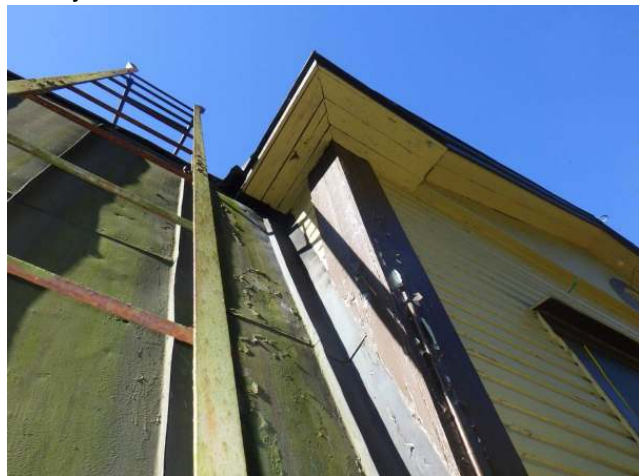
36. Pellityksen ja verhouksen liitos ei ole tiivis
