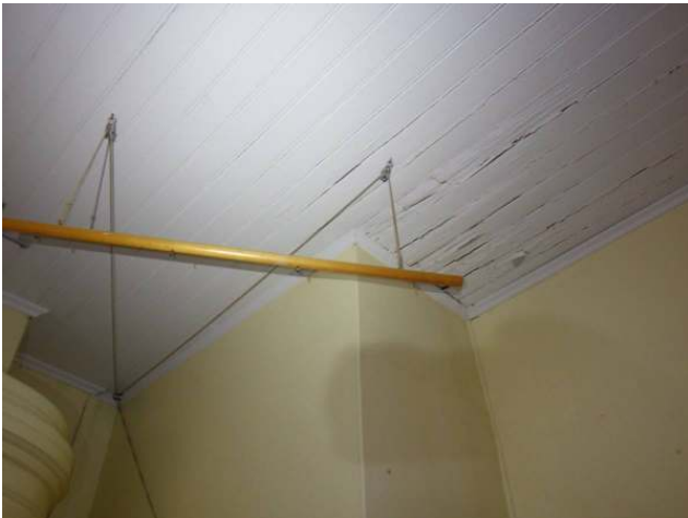
51. Kosteuden aiheuttamat jäljet muissa tiloissa
