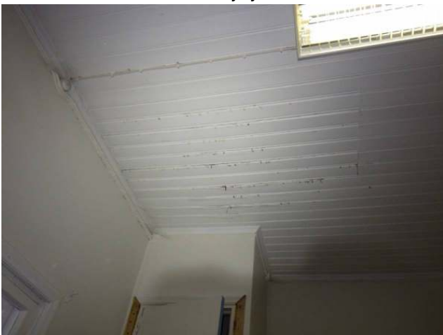
53. Kosteuden aiheuttamat jäljet muissa tiloissa
