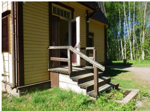
6. Kuistin portaissa on painumaa ja puuosissa vaurioitumista
