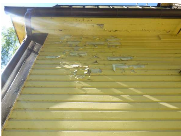
16. Puuosissa ja maalipinnassa on kulumista
