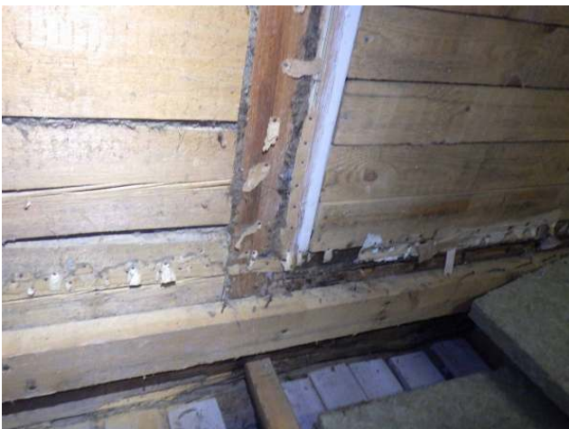
27. Väliseinän alaosassa on hirsiseinässä vaurioita
