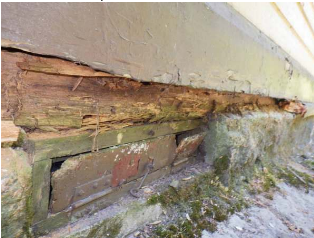
25. Pihan puolella on seinän alaosassa lahovaurioita
