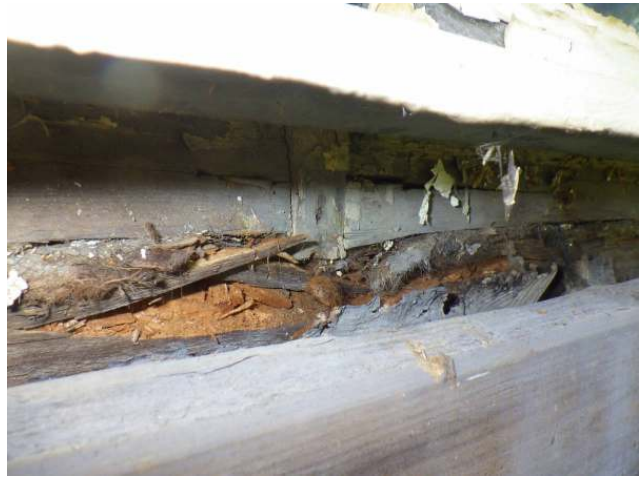
24. Ikkunan alla havaittiin vähäisiä lahovaurioita
