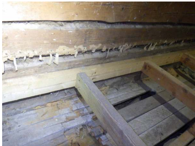
26. Sisäpuolella on ulkoseinän alaosassa vaurioita samassa kohdin kun ulkopuolella havaittiin
