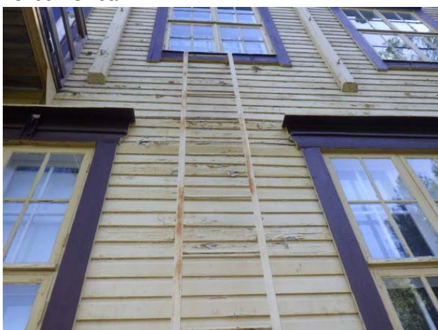
15. Puuosissa ja maalipinnassa on kulumista
