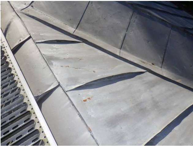
33. Vesikatteessa on ruostumista
