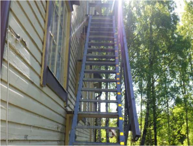
7. Ulkoportaiden alaosasta puuttuu alimmat askeleet
