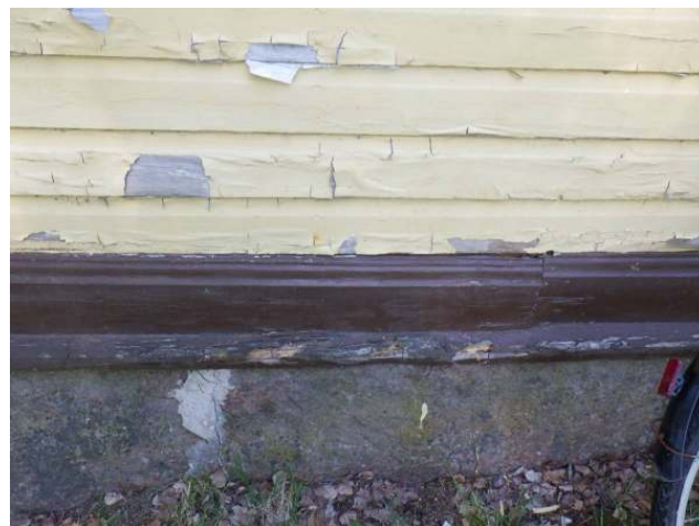
18. Seinän alaosassa on paikoin puuosissa vaurioitumista
