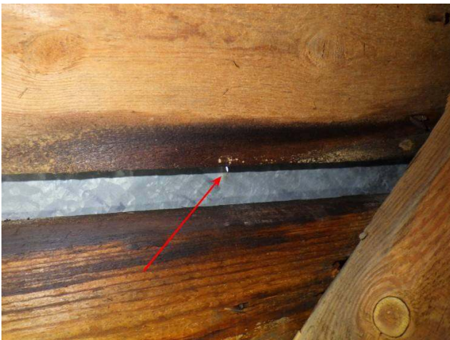
35. Vesikatteessa on pieni reikä
