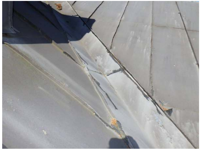
34. Jiirin kohtaa on tiivistetty tiivistysmassalla ja tiivistysmassan osalla on havaittavissa kulumista
