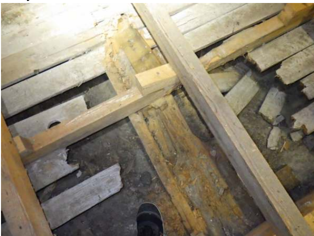
5. Alapohjassa havaittiin kantavan palkin osalla lahovaurioita
