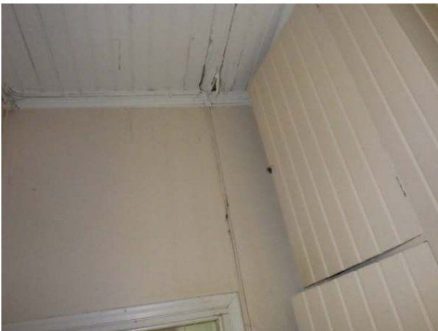
49. Kosteuden aiheuttamat jäljet muissa tiloissa
