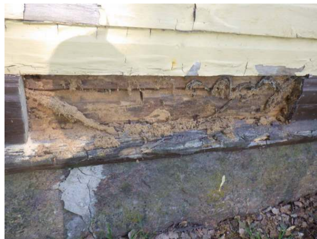
20. Päädyssä havaittiin alimpien hirsien osalla lahovaurioita
