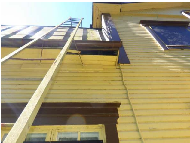
19. Räystään kohdalla on verhouksessa vaurioitumista
