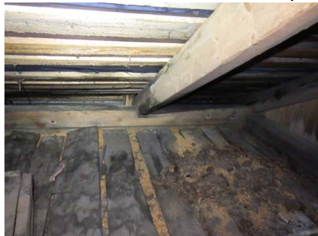
42. Yläpohjan osalla havaittiin kosteusjälkiä
