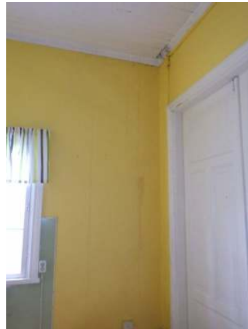
52. Kosteuden aiheuttamat jäljet muissa tiloissa
