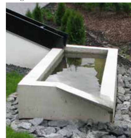
En konstruktionsmässig bassäng för insamling av dagvatten
