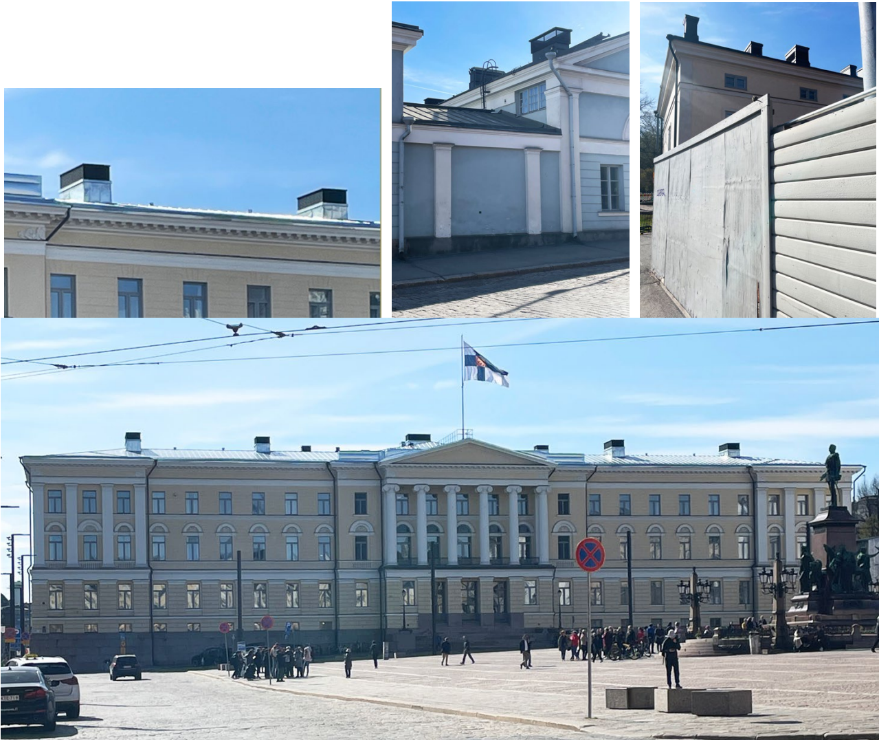
Bild 37 Referensbilder på reparationsobjekt, där den nya taktekniken har koncentrerats till visuellt enhetliga luftkanalsgrupper (NEMO arkitektdit Oy)
