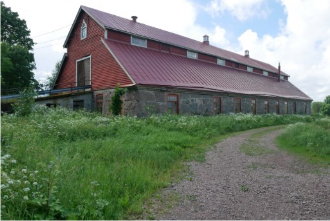
Den monumentala ladugården på Snickars (21) är byggd av robusta granitblock. Taket är indelat i en lanternindel och nedre takfall. I den södra gaveln leder en körbro upp till vinden. (A24)
