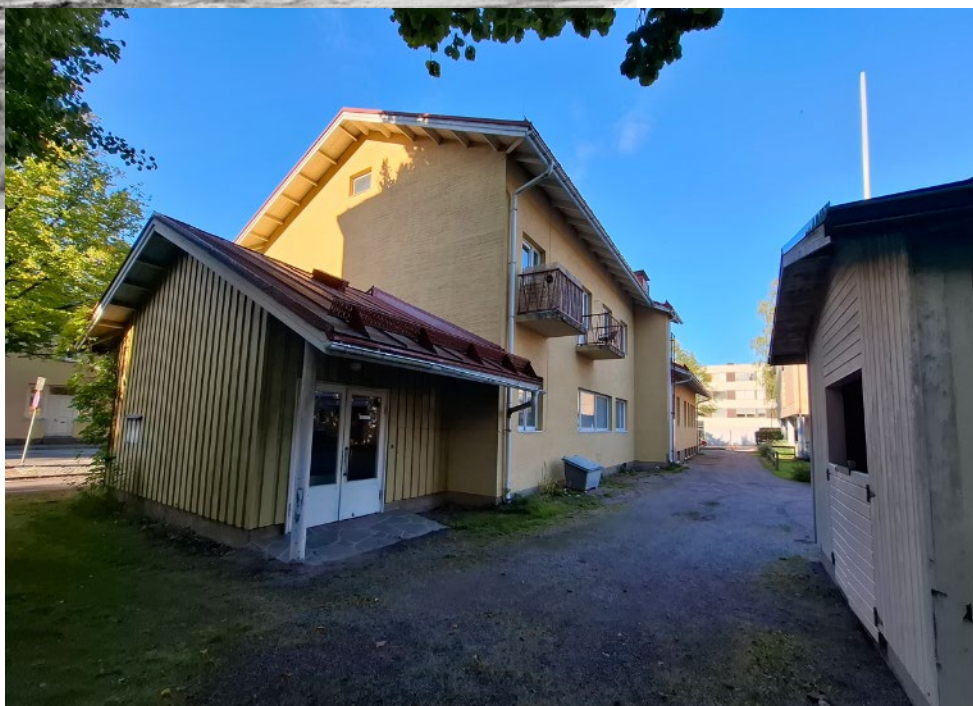
Kuva 5. Kuvapari. Yläkuvassa Lundintalo luultavasti pian valmistumisen jälkeen kaakosta Rauhankadulta nähtynä. Kuvasajankohta ei ole tiedossa. Kuvaaja: E.Nurmi, lähde: Porvoon museo / Rakennushistoriaselvitys (FCG 2018, 2024). Alakuvassa Lundintalo laajakulmaobjektiivilla kuvattuna lounaasta 1.9.2025. Oikealla näkyvästä talousrakennuksesta ei löydy toteutusajankohtatietoa, mutta se lienee 1990-luvulta.
