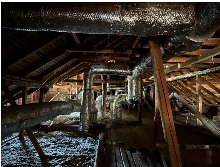
Kuva 25. Näkymä ullakolta, johon on sijoitettu koneellisen ilmanvaihdon tekniikkaa.
