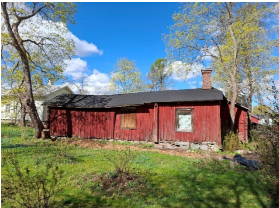
Bild 18. Den del där gästgiverin fanns är i mycket dåligt skick. Bagarstugan har en högre sockel staplad av sten och ett fönster med en glastruta.
