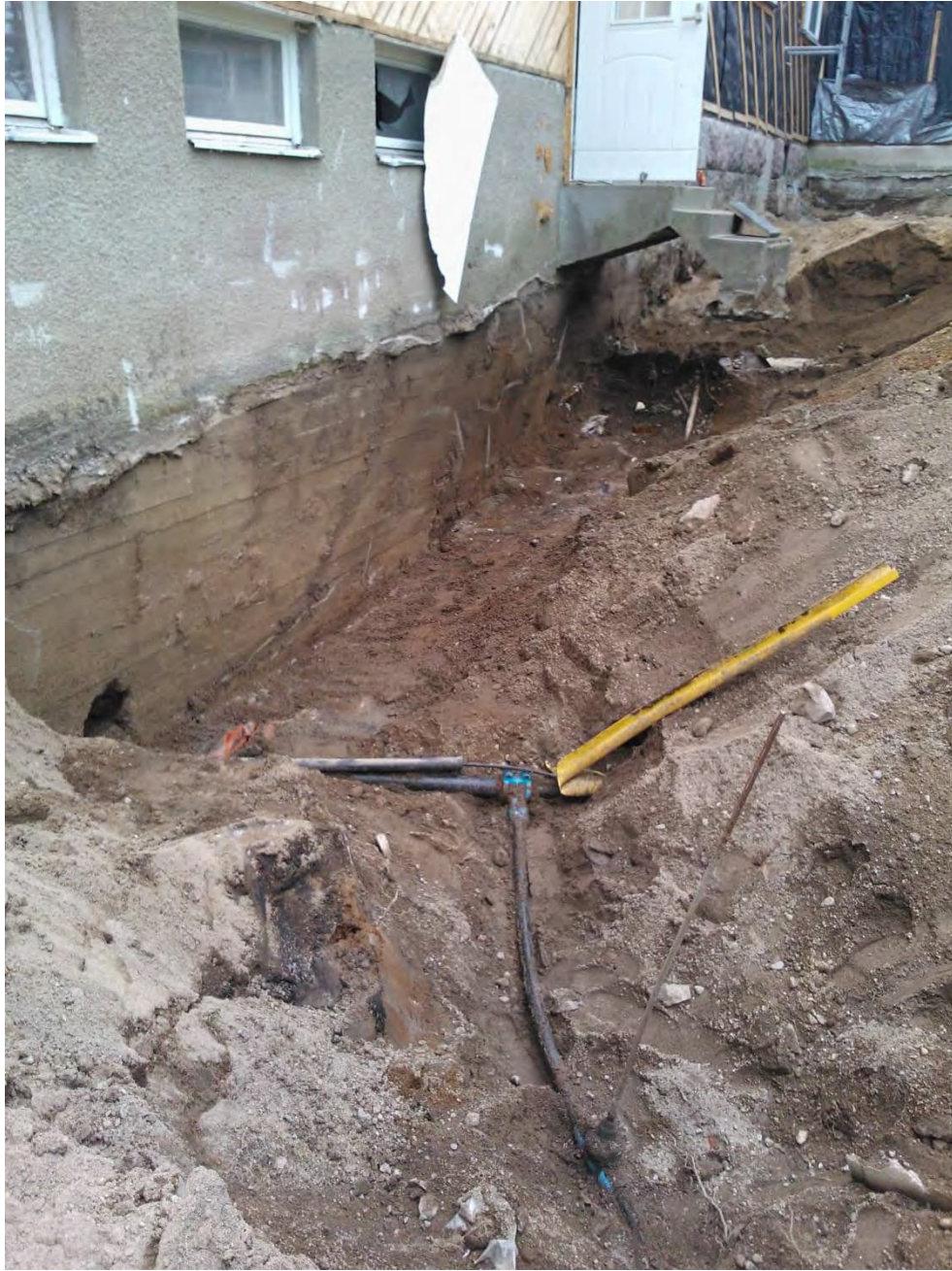
Kuva 9. Tutkimuspiste 9 ja 10 ottopaikka. Vesijohdon syöttö.
