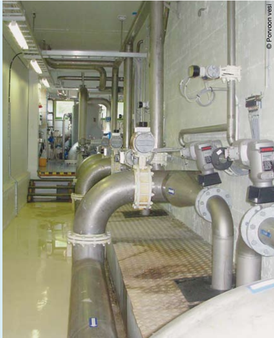
Kuvassa Saksalan vedenottamon prosessilaitteistoja. Laitteistojen hyvä kunto on edellytys juomaveden laadulle ja turvallisuudelle.
