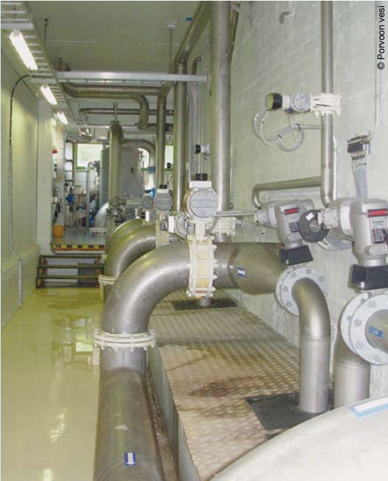
Processutrustning i Saxby vattentäkt. För att kunna garantera dricksvattnets kvalitet och trygghet måste utrustningen hållas i toppskick.
