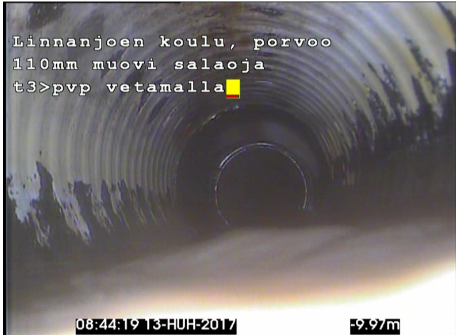
Kuva: T3_PVP_142500_7_2.jpg 0,22m, Täyttöaste, Alku
