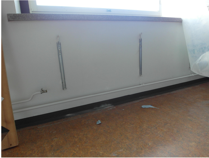
Kuva 1. Patterin ja putken kannakkeiden kiinnikkeistä löydöi paikoitellen vuotokohtia.
