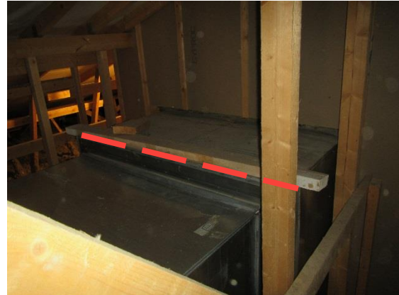
Kuva 4. Ullakon puolella kanava on lämmöneristetty vain osan matkaa. Lämmöneristys loppuu katkoviivan kohdalla.
