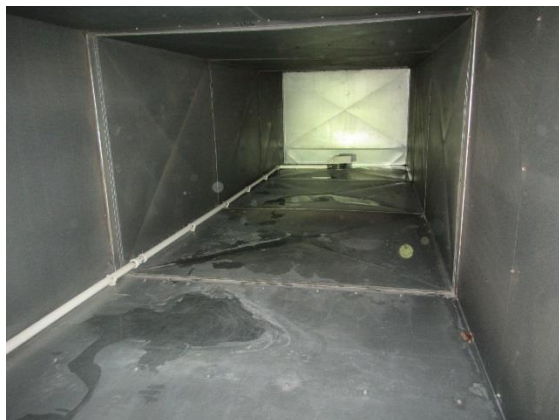
Kuva 1. Kanavan pohjalle on lammikoitunut vettä.
